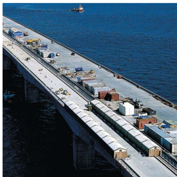
Under udlægning blev der anvendt rullende telte, der sikrede konstant fremgang uanset vejrliget
